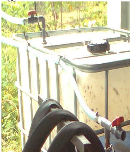
Gambar 6. Sistem saluran gas (Pipa saluran biogas, 2015)
