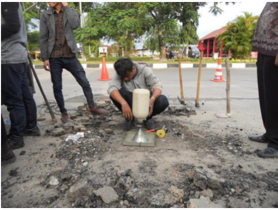
Gambar 3. Kegagalan badan jalan, uji core drill , test pit dan uji sand cone .
